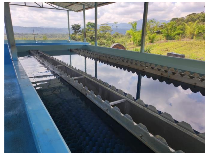
Abastecimiento del servicio de agua potable para los sectores urbanos y rurales del Cantón Mera
